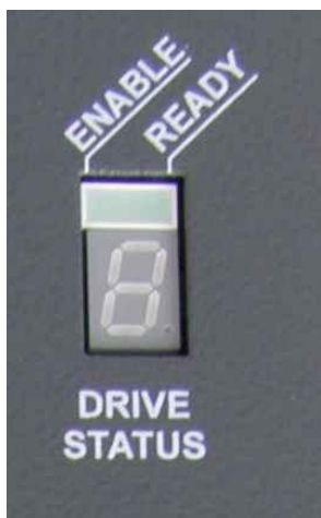
Рис. 4.21. Индикаторы состояния серворегулятора.
